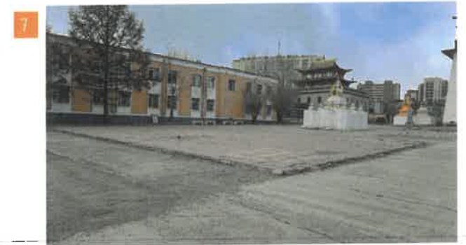
Хэлбэржүүлсэн өнгөт хавтан болон бетон хашлага эвдэрсэн
